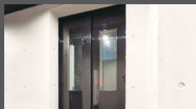
防犯窓付きエレベーター
