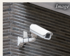
共用部防犯カメラ2台
