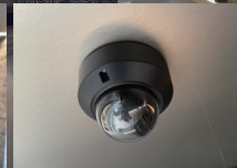
共用部に 防犯カメラ2台設置
