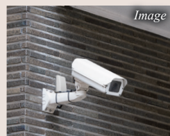
共用部防犯カメラ2台
