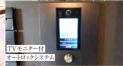
共用部に防犯カメラ3台設置
