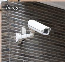
安全性に配慮し、共用部に防犯カメラ2基設置
