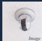
防犯カメラ 2台設置
