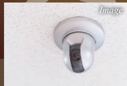
共用部防犯カメラ3台設置
