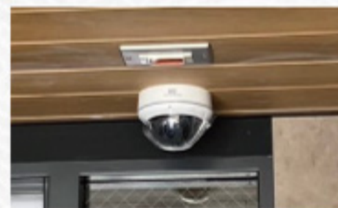
共用部防犯カメラ 4台設置
