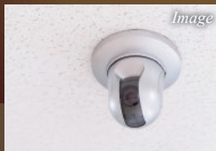
共用部防犯カメラ3台設置
