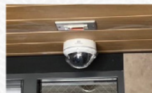
共用部防犯カメラ 4台設置
