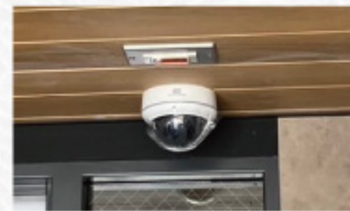
共用部防犯カメラ 4台設置
