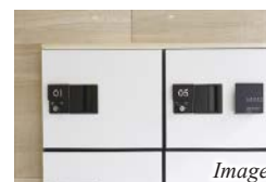
宅配ボックス
